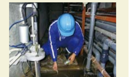
共同溝排水マスでのpHチェック
