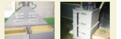
粗洗浄槽を1槽追加設置し、粗洗浄液を回収するようにしました。排水処理装置を改造し、フッ素除去ができるようにしました。
