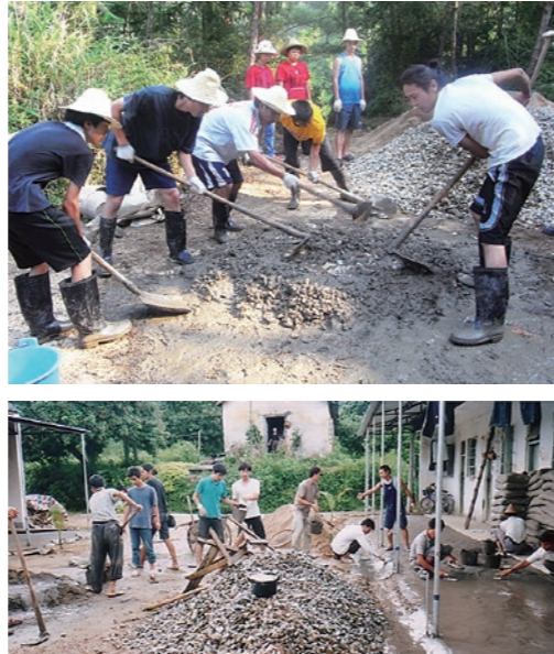
1960年代に建てられ、修理されていない家屋が多く、ワークキャンプでは水道やトイレなどを設置する
