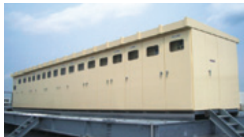
東京事業所内変電所
