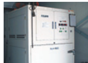
汚泥減容装置
