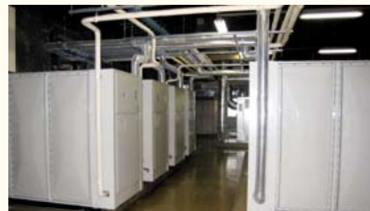
蓄熱式ヒートポンプシステム
